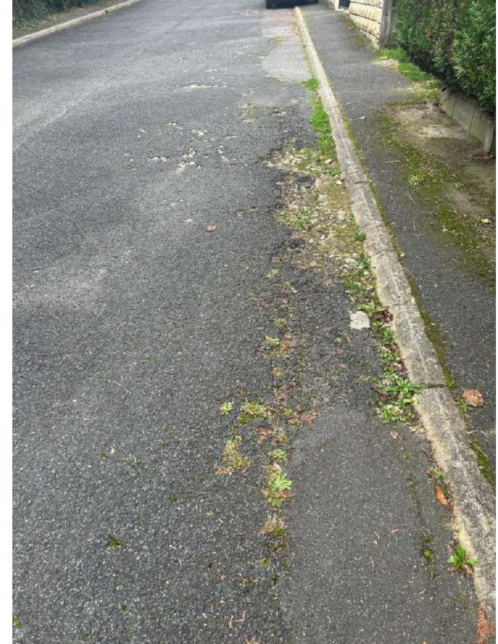
Zoom sur l'état de l'enrobé
